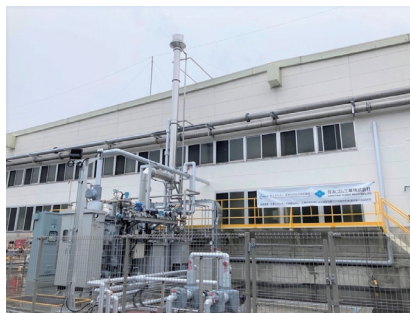
水素ボイラー
