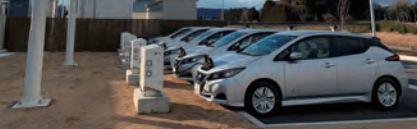
EV充電を再生エネルギー100%にする実証実験
