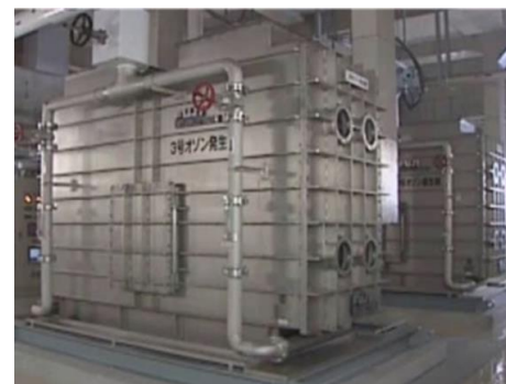
オゾン発生装置（朝霞浄水場） [2]
