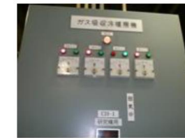
計器場所例(個別の制御盤)
