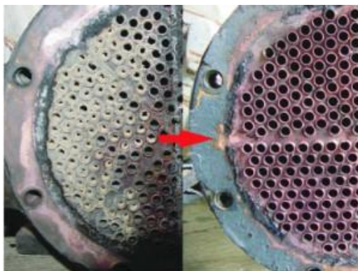
スケール除去前後の熱交換器内面 [1]
