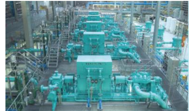
高圧ROポンプ・動力回収装置（福岡地区水道企業団まみずピア） [2]
