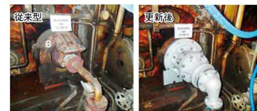
▲ドレン排出装置（ドライヤーロータリージョイント）
