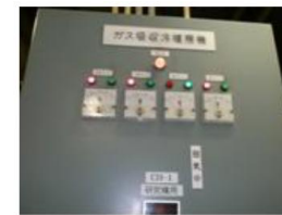
計器場所例(個別の制御盤)
