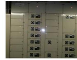
計器場所例(集中配電盤)
