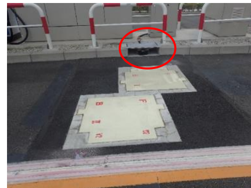
本事業で使用した コイル脇に設置した異物検知システム
