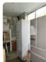
4 F 教材室: ・負荷用 DC/DC コンバータ ・直流分電盤
