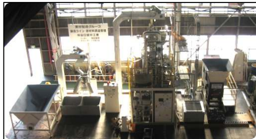
受入ホッパー、分別装置、搬送装置 洗浄装置 圧縮装置
