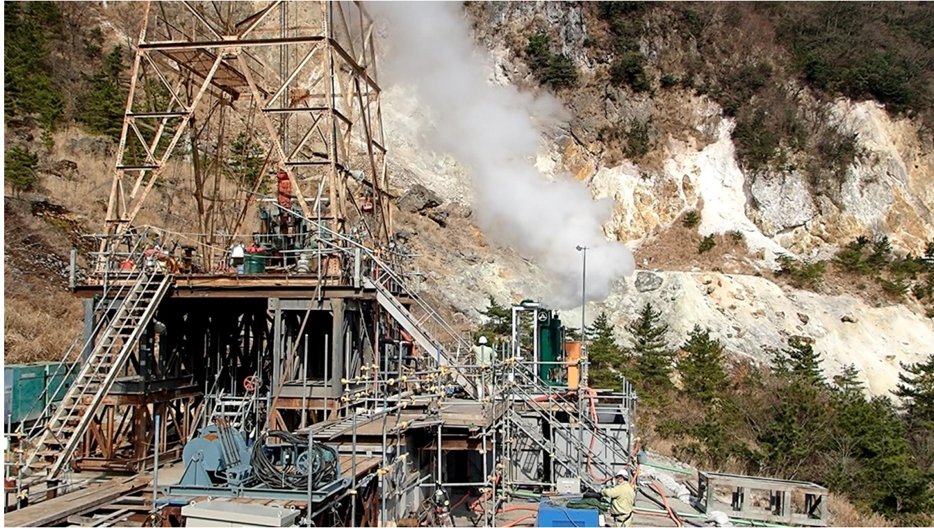
写真① 循環試験実施状況
