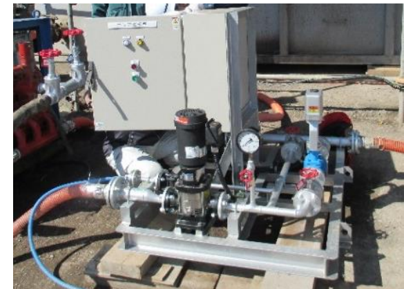
写真④ 調温ユニット
