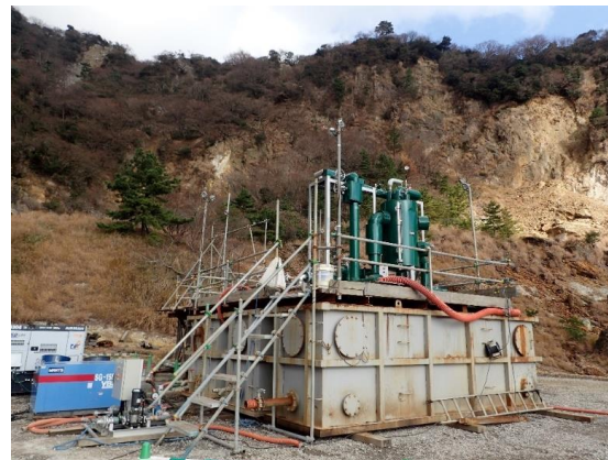
写真③ 蒸気発生ユニット
