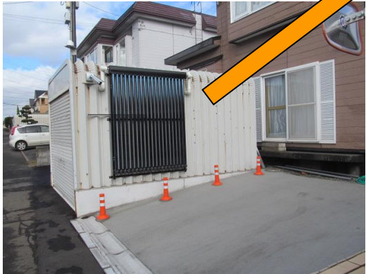
太陽熱集熱器設置状況 (平岡地区のみ設置)
