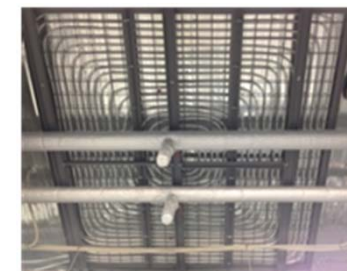
スラブ下面設置型の放熱配管ユニット。
