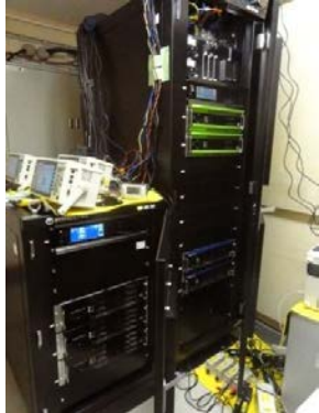
左：リチウムイオン蓄電池 充放電器 右：直流電力変換装置
