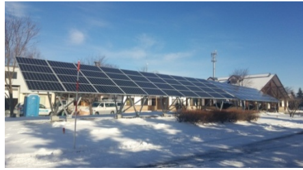
太陽光パネル (10 kW×2)
