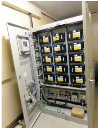
リチウムイオン蓄電池
