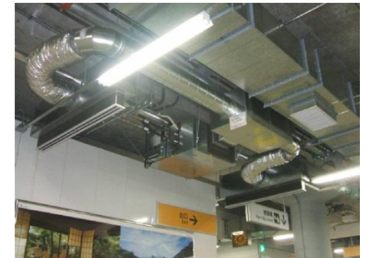
地下2F 地中熱ヒートポンプ 設置状況
