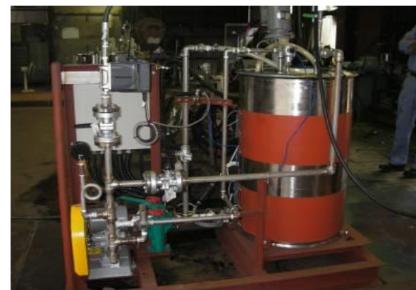
バイオオイル噴霧試験装置の外観
