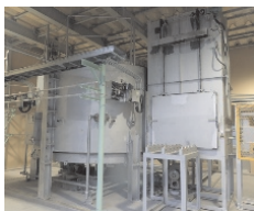
Li-ion電池リサイクル設備
