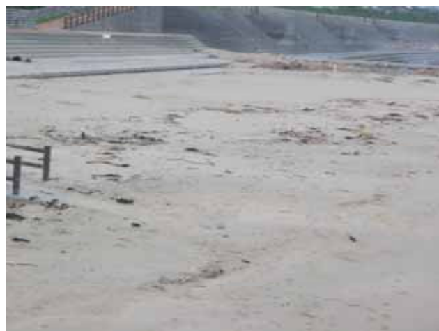
撮影方向②の海岸の状況（ズーム）
