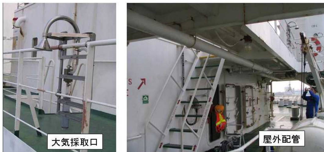
図4 連続測定器の大気採取口と屋外配管
