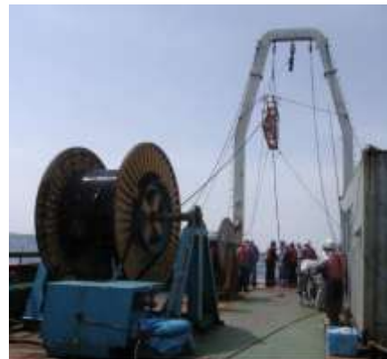
図5 電源伝送ケーブル
