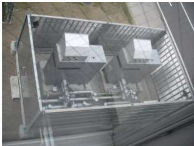
導入設備 (コージェネレーションシステム)
