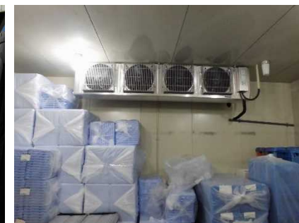
庫内（ユニットクーラー） 冷凍庫内の設置状況。
