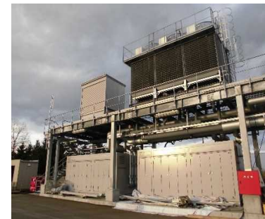
屋外での機器設置状況 下段に冷凍ユニット、架台上段に冷却塔や除害装置を設置。
