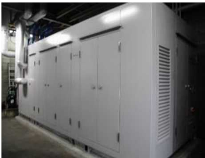
冷凍ユニット。機械室での設置状況。
