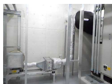
ダクト・ダクト霜取りヒーターユニット。 超低温空気を倉庫内へ送るダクト配管。除霜ヒーターを内蔵。
