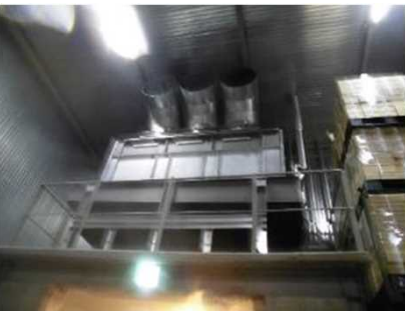
ユニットクーラー 架台上に設置し、冷気を対流させている。
