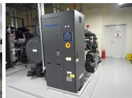
冷凍機ユニット。 機械室内での設置状況。
