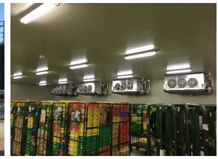
室内機 (ユニットクーラー) トラック積み下ろし場に隣接する低温室での設置状況。
