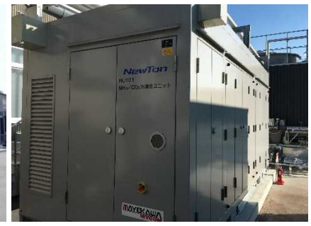
冷凍ユニット アンモニア冷媒圧縮機などの機器が格納されている。
