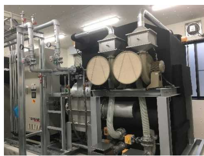
空気冷媒冷凍ユニット。 超低温冷凍庫に隣接する屋内に設置されている。
