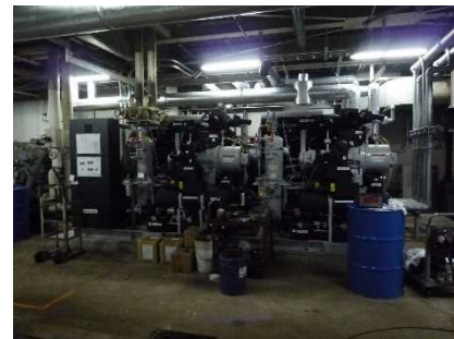
冷凍ユニット 機械室内での設置状況。
