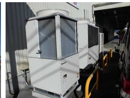
コンデンシングユニット 冷凍倉庫および冷蔵倉庫への冷熱供給を行う。
