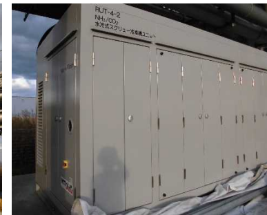
冷凍ユニット 内部にはアンモニア冷媒圧縮機やポンプ類が格納されている。
