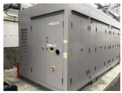
冷凍ユニット アンモニア冷媒圧縮機などの機器類が格納されている。
