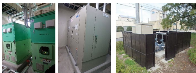
ヒートポンプユニット
