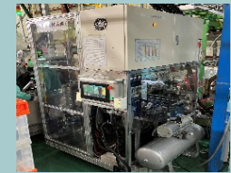
①プラスチックリユース設備
