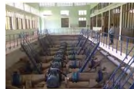
高効率ポンプ (ベトナム)
