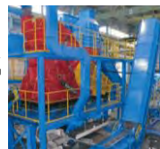
金属破碎・選別設備
