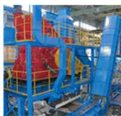
金属破砕・選別設備
