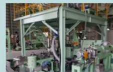
バイオマスプラスチック製造設備
