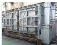
Li-ion電池 リサイクル設備
