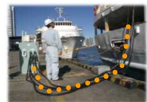
電力供給設備
