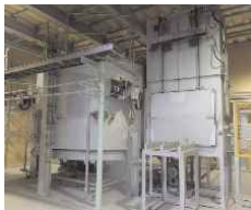
Li-ion電池リサイクル設備
