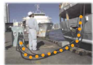
電力供給設備
