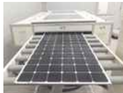
太陽光発電設備リサイクル設備
