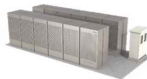
自立型電源 (蓄電池設備含む)
