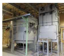
Li-ion電池リサイクル設備
