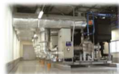
＜中央方式冷凍冷蔵機器＞
