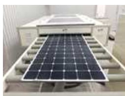
太陽光発電設備リサイクル設備
