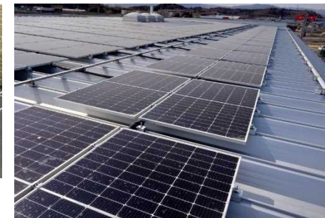
太陽光発電設備②
