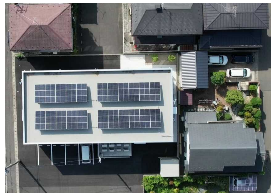
太陽光発電設備
