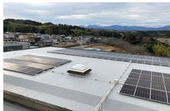
太陽光発電設備
