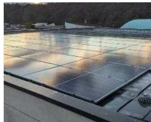
太陽光発電設備
