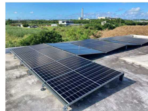
屋根上タイプの設備設置状況
