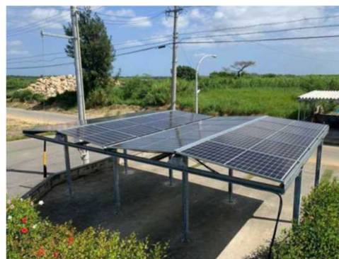
カーポートタイプの設備設置状況
