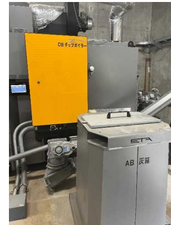
チップボイラー
