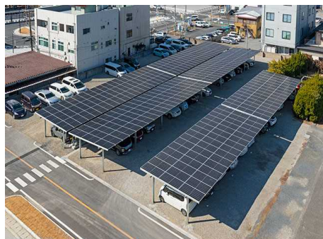
太陽光発電設備
