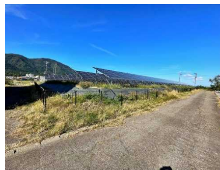
太陽光発電設備
