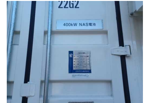
定置用蓄電池
