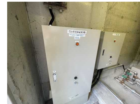
インバータ制御盤
