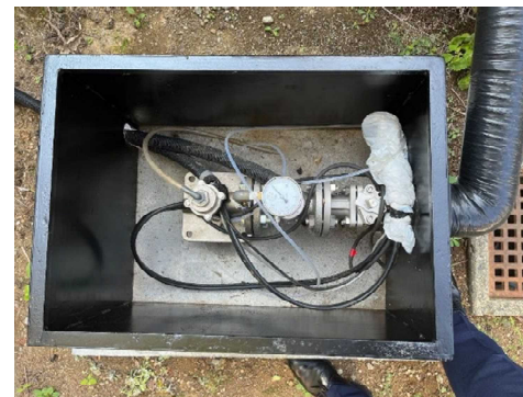
揚湯設備 (水中モーターポンプ)
