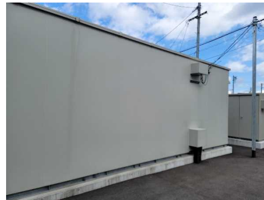
対象施設の外観 (コンテナ型データセンター)
