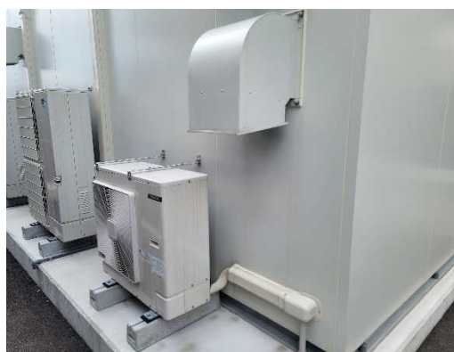
空調、換気設備（屋外部）
