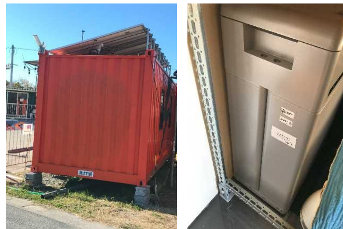
太陽光発電パネル、蓄電池
