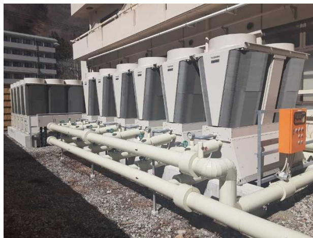
高温水ヒートポンプ(写真手前) 空冷ヒートポンプチラー(写真左奥)
