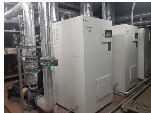
温水ボイラー
