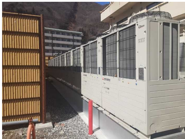
ヒートポンプ給湯機
