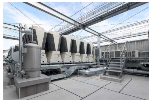
空調設備（モジュールチラー）
