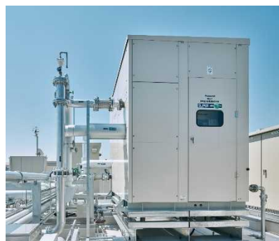
排熱回収型吸収式冷温水器
