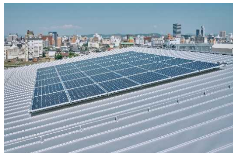
太陽光発電設備
