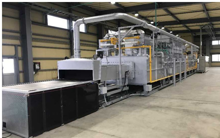
熱分解処理炉
