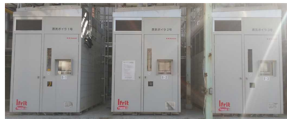
ガス焚き蒸気ボイラ
