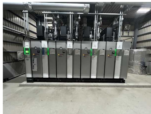
ガス焼きボイラ
