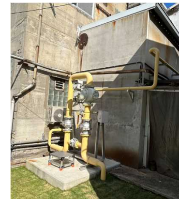
ガス配管設備
