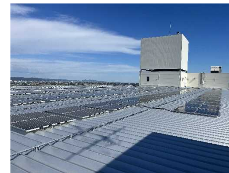
太陽光発電設備
